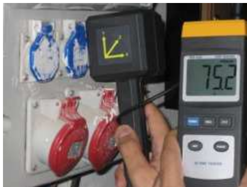
Misura delle radiazioni elettromagnetiche emesse da un quadro elettrico
