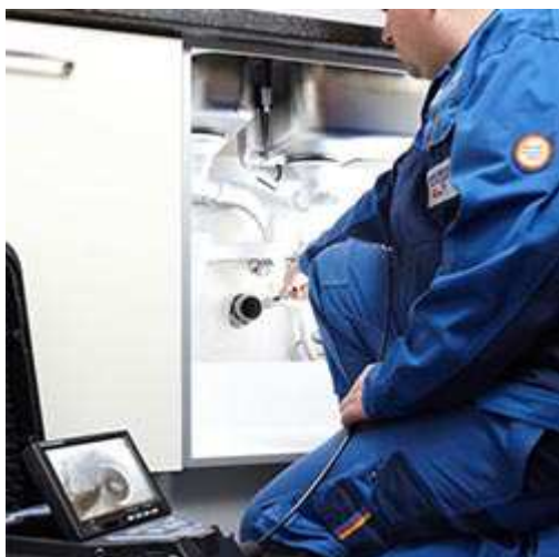
Controllo delle tubature nello scarico di una cucina.
