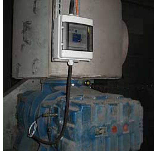
Analizzatore di vibrazioni piezoelettrico collegato a una compattatrice
