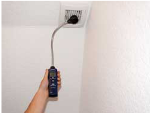
Il termoanemometro con ruota ad alette PCE-TA 30 mentre controlla un condotto di aspirazione
