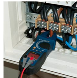
Misura della corrente con la pinza amperometrica a ganasce aperte
