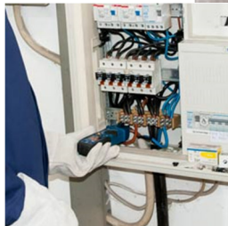
Misura della corrente in un armadio di distribuzione con la pinza amperometrica a ganasce aperte
