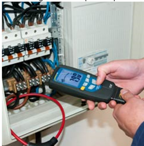
Misura effettuata con la pinza PCE-CM 40 in un armadio di distribuzione
